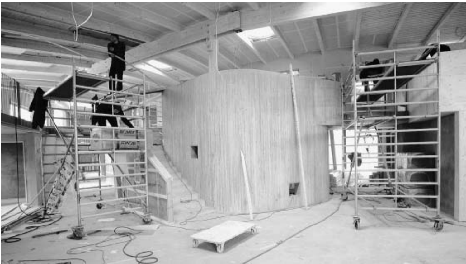
Der Innenausbau kommt voran: Verschiedene Materialien, geschwungene Wände, Oberlichter und Türme sollen die Kindertagesstätte im Technologiepark zum Entdeckerhaus machen. FOTO: JOCHEN STOSS
