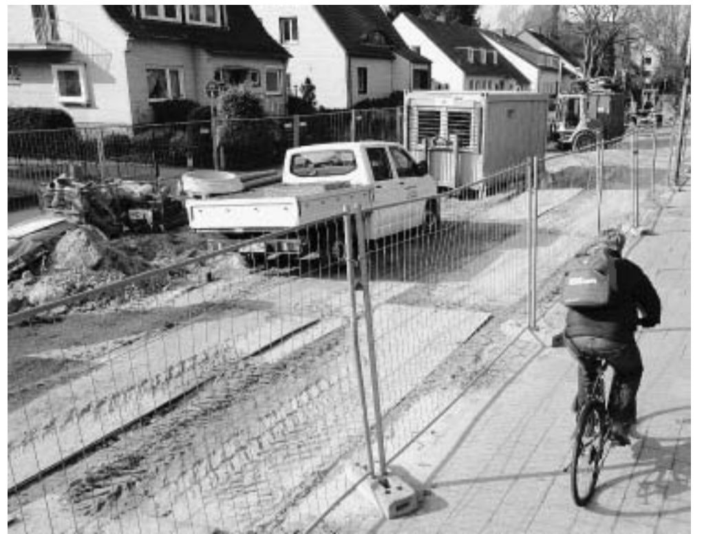
Hätte bei der Sanierung des Baumschulwegs Geld gespart werden können? Die SPD-Baupolitikerin Uta Kummer und die Baubehörde sind unterschiedlicher Meinung. FOTO: JOCHEN STOSS
